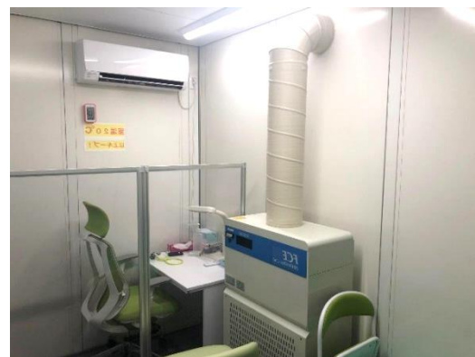
仮設プレハブ診察室内の簡易陰圧装置
