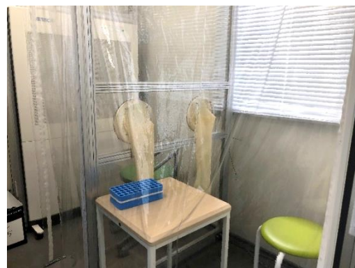
仮設プレハブ検査室内のエアータック装置
